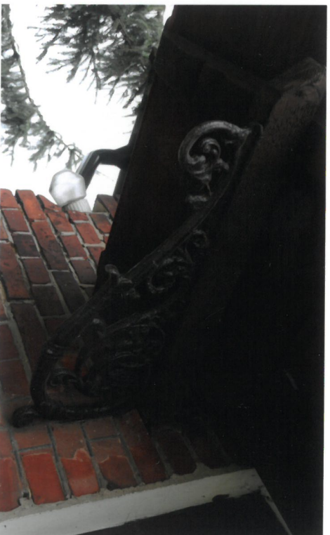
Zelwiny wspornik okapu nad wejściem do budynku od strony zachodniej
