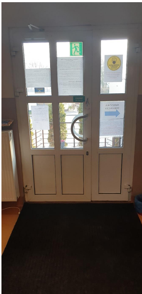
Zdjęcie przedstawia drzwi wejściowe do budynku urzędu gminy w Godzieszach Wielkich, od strony wewnętrznej wraz z istniejącym progim o wysokości 6 cm
